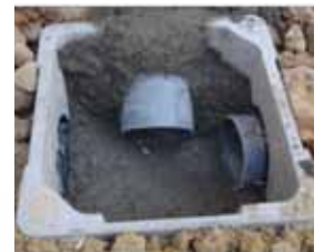
Regard de collecte des eaux grises
