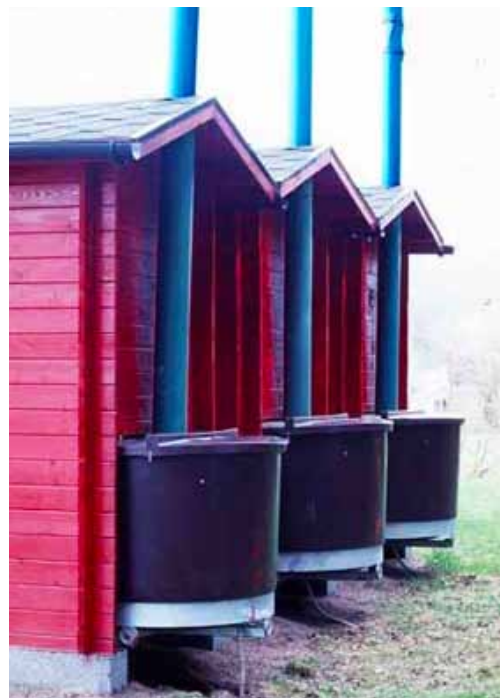
Composteurs extérieurs et ventilation passive
